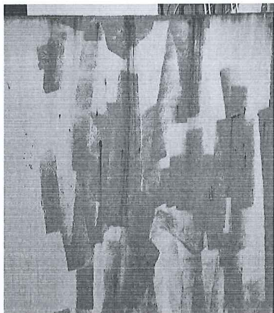
一体化水箱受锈蚀情况
